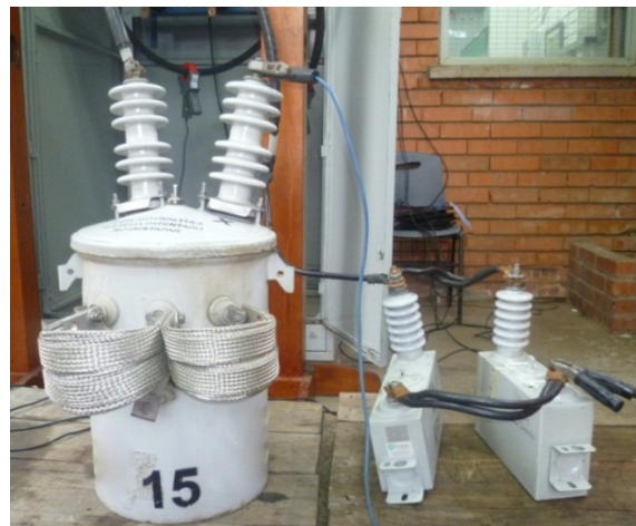
Fig.4: Transformado bajo prueba de cortocircuito
