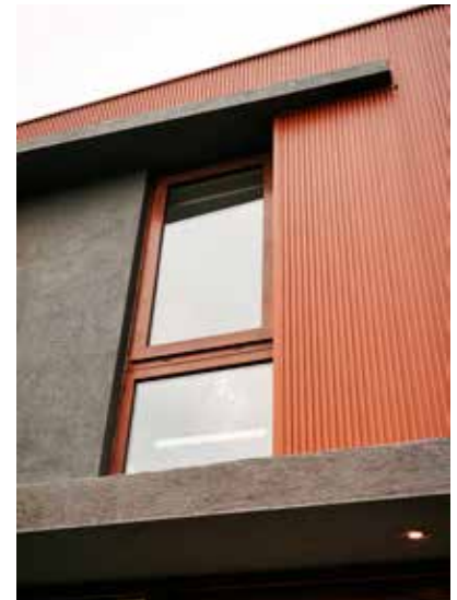
FIG 7 Casa piloto, etapa 1A, detalle de revestimiento exterior segundo piso. / Model house, stage 1A, second level facade detail. © Felipe Encinas
